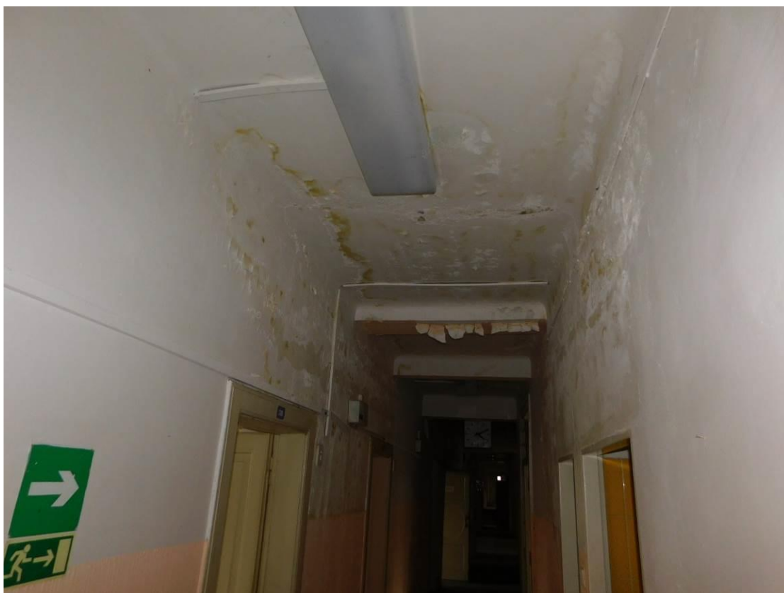
Foto 149 – Zikova 1 – 4.NP (lokalizace v Příloze 1) – zjištěny plošné průsaky způsobené havárií rozvodů vody či kanalizace
