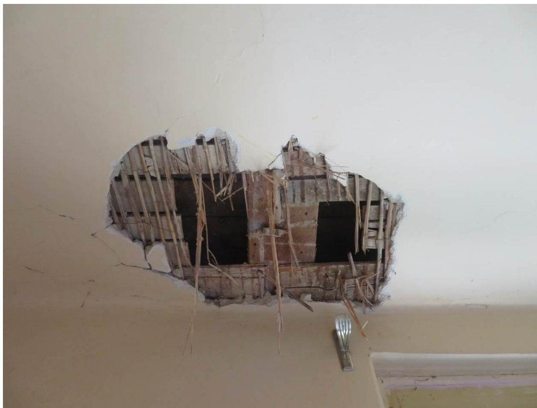
Foto 115 – Šolínova 3 – 4.NP – sonda SS20 – dřevěný trémový strop
