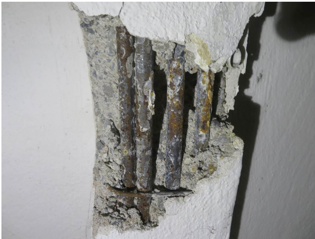
Foto 75 – Šolínova 1 – 1.PP – sonda SS2/T2,D2 – sonda do stropního trámu, viditelná lokální povrchová koroze výztuže
