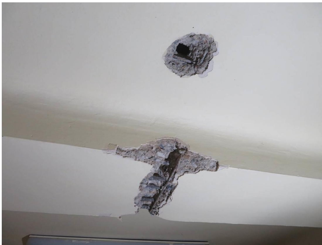
Foto 81 – Šolínova 1 – 2.NP – sonda SS5/T3,D3 – žb strop chodby
