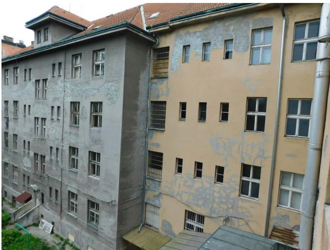
Foto 10 – Celkový pohled na objekty Šolínova 3 a Zikova 1 – pohled dvorní – viditelné pouze lokální opravy fasády
