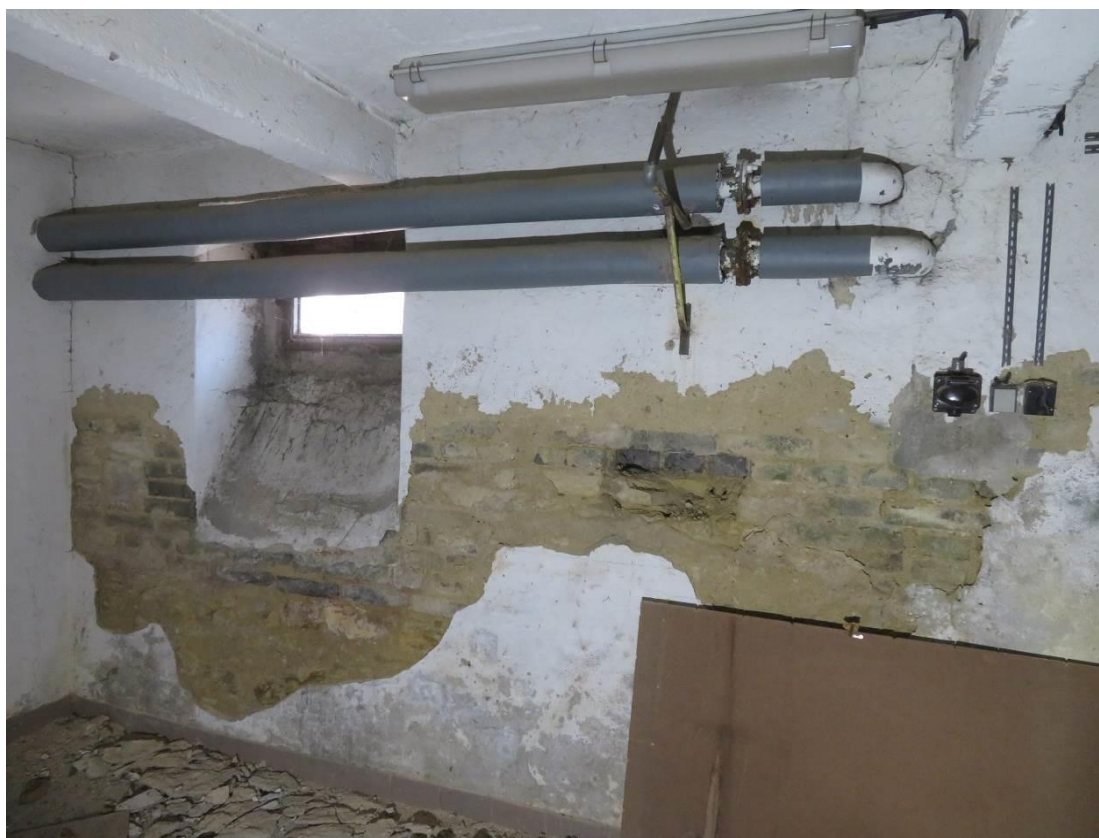
Foto 30 – Objekt Šolínova 3 – 1.PP – sonda Z1 – viditelné smíšené zdivo z opuky a betonových cihel, odběr vzorku kamene K2/1, viditelná zvýšená vlhkost zdiva
