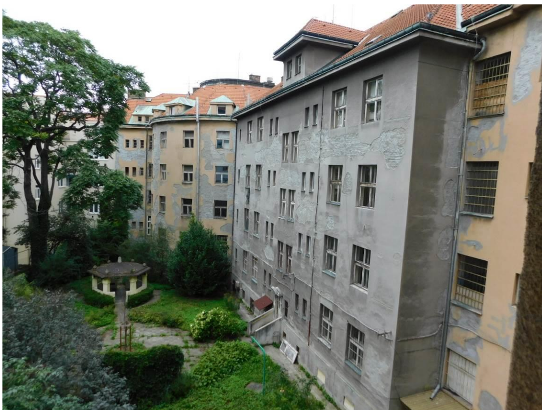
Foto 8 – Celkový pohled na objekty Šolínova 3 a Zikova 1 – pohled dvorní – viditelné pouze lokální opravy fasády
