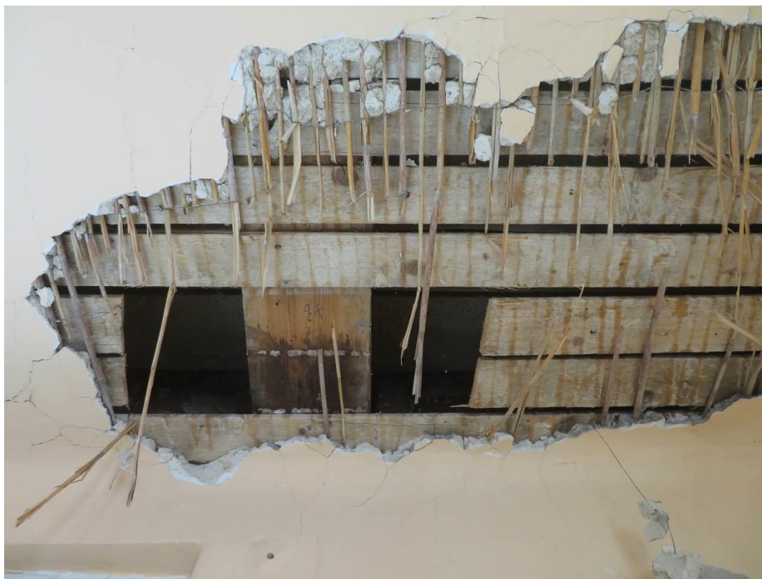
Foto 91 – Šolínova 1 – 5.NP – sonda SS10 – dřevěný trémový strop
