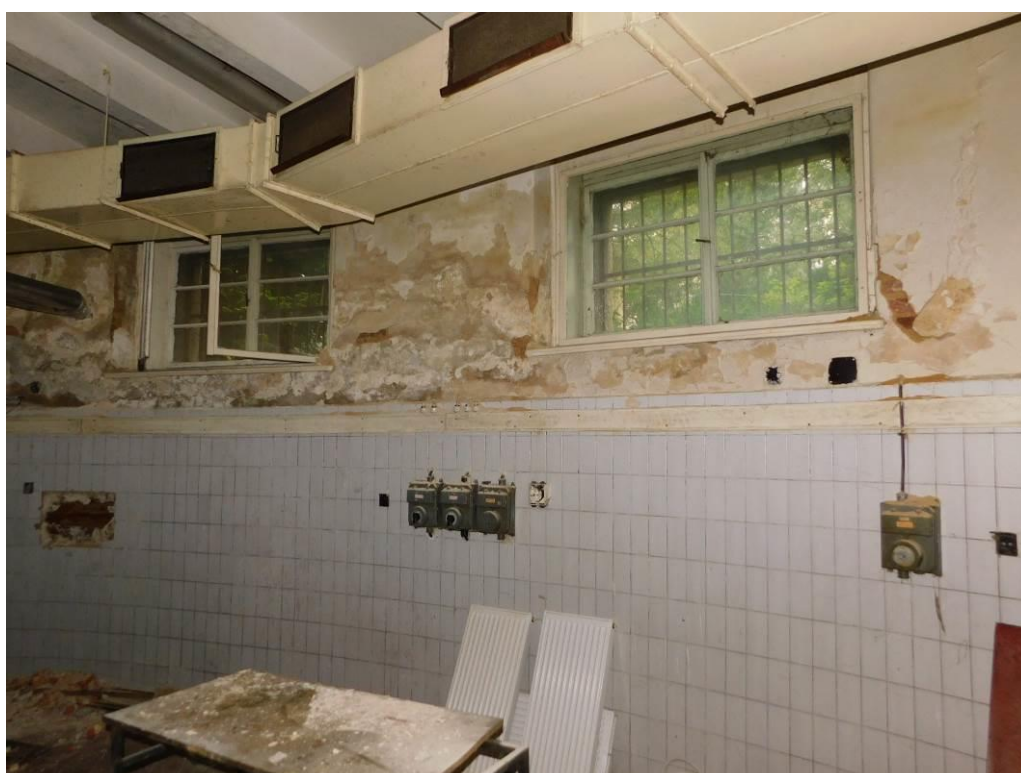
Foto 46 – Zikova 1 – 1.PP (lokalizace v Příloze 1) – viditelná zvýšená vlhkost zdiva
