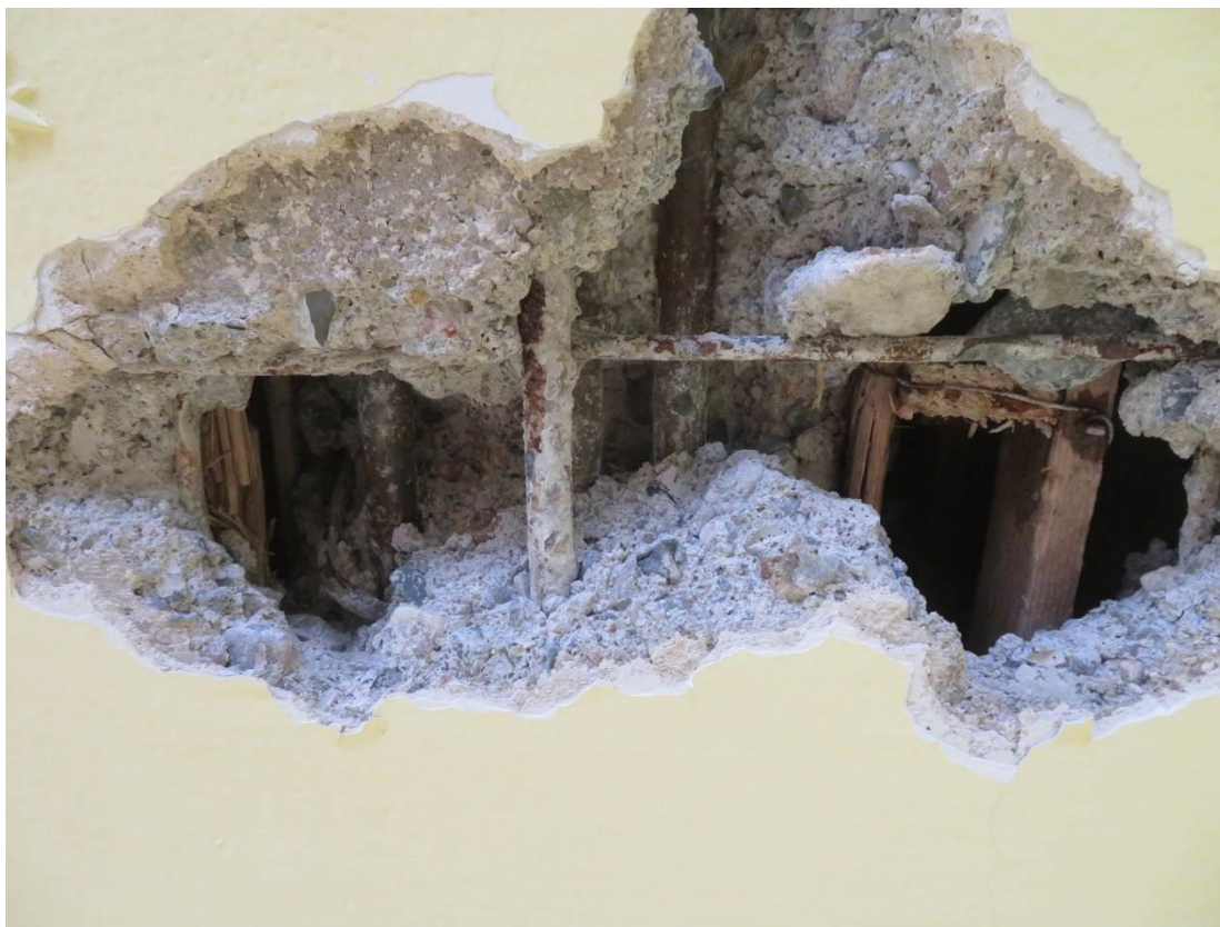
Foto 123 – Zikova 1 – 1.NP – sonda SS23/T10,D10 – sonda do stropního trámu a desky, detail sondy k výztuži
