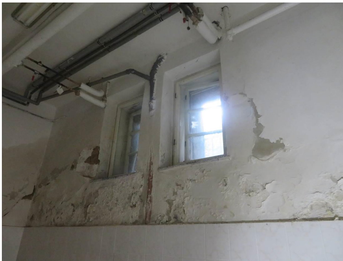
Foto 51 – Zikova 1 – 1.PP (lokalizace v Příloze 1) – viditelná zvýšená vlhkost zdiva
