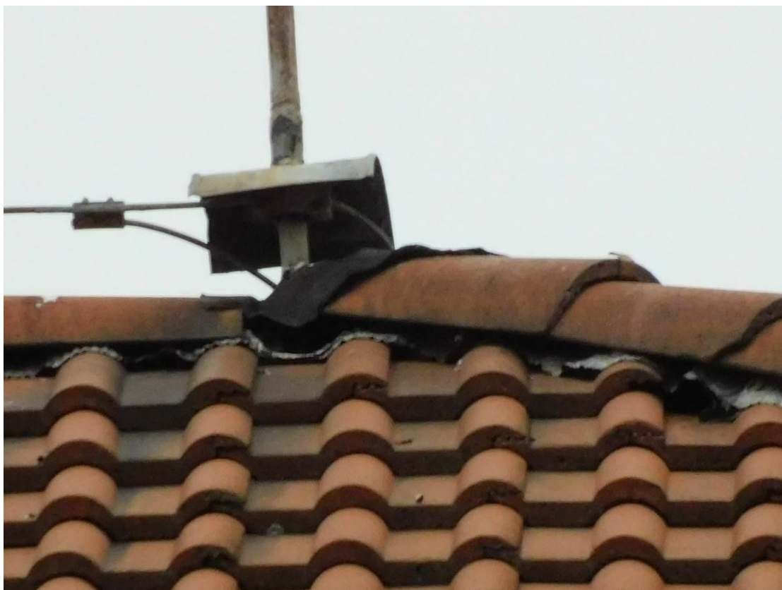
Foto 3 – Celkový pohled na objekt v ul. Šolínova 1 – pohled z ulice Evropská – detail střešní krytiny a oblasti vsazení hromosvodu – špatně provedený detail, může zatékat
