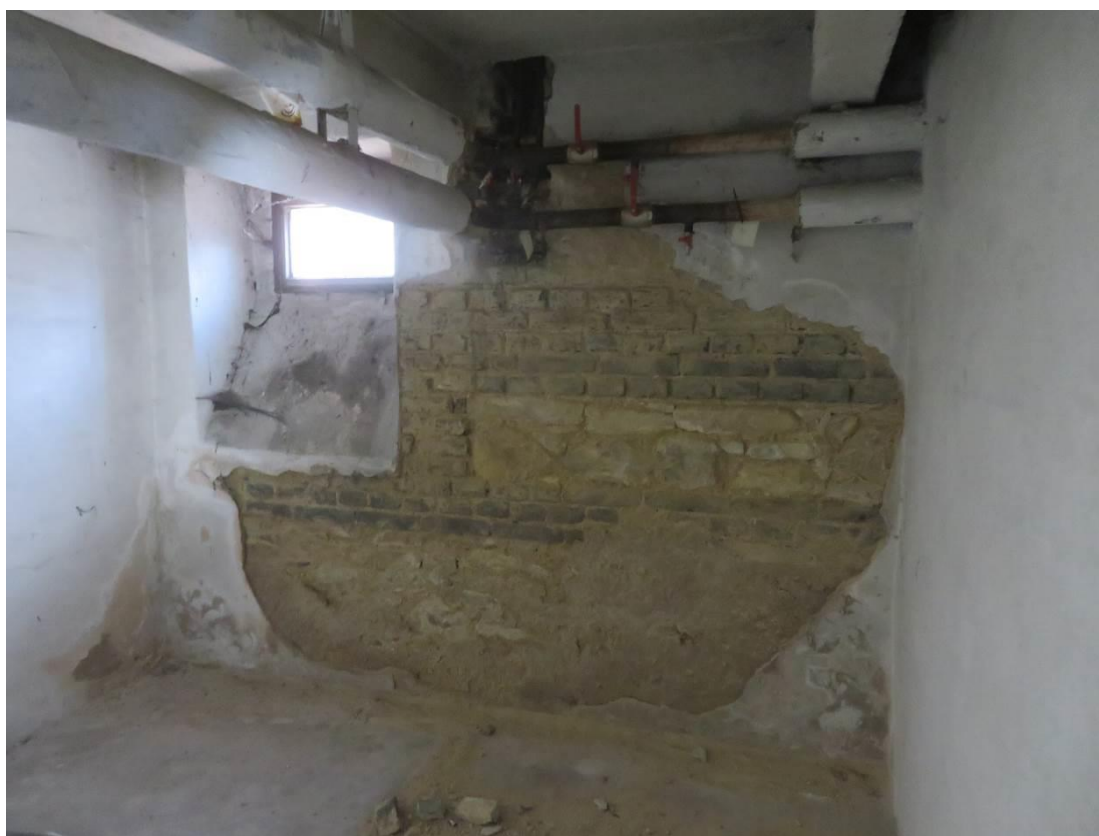
Foto 32 – Šolínova 3 – 1.PP (lokalizace v Příloze 1) – viditelné smíšené zdivo z opuky a betonových cihel, viditelná zvýšená vlhkost zdiva obvodové stěny
