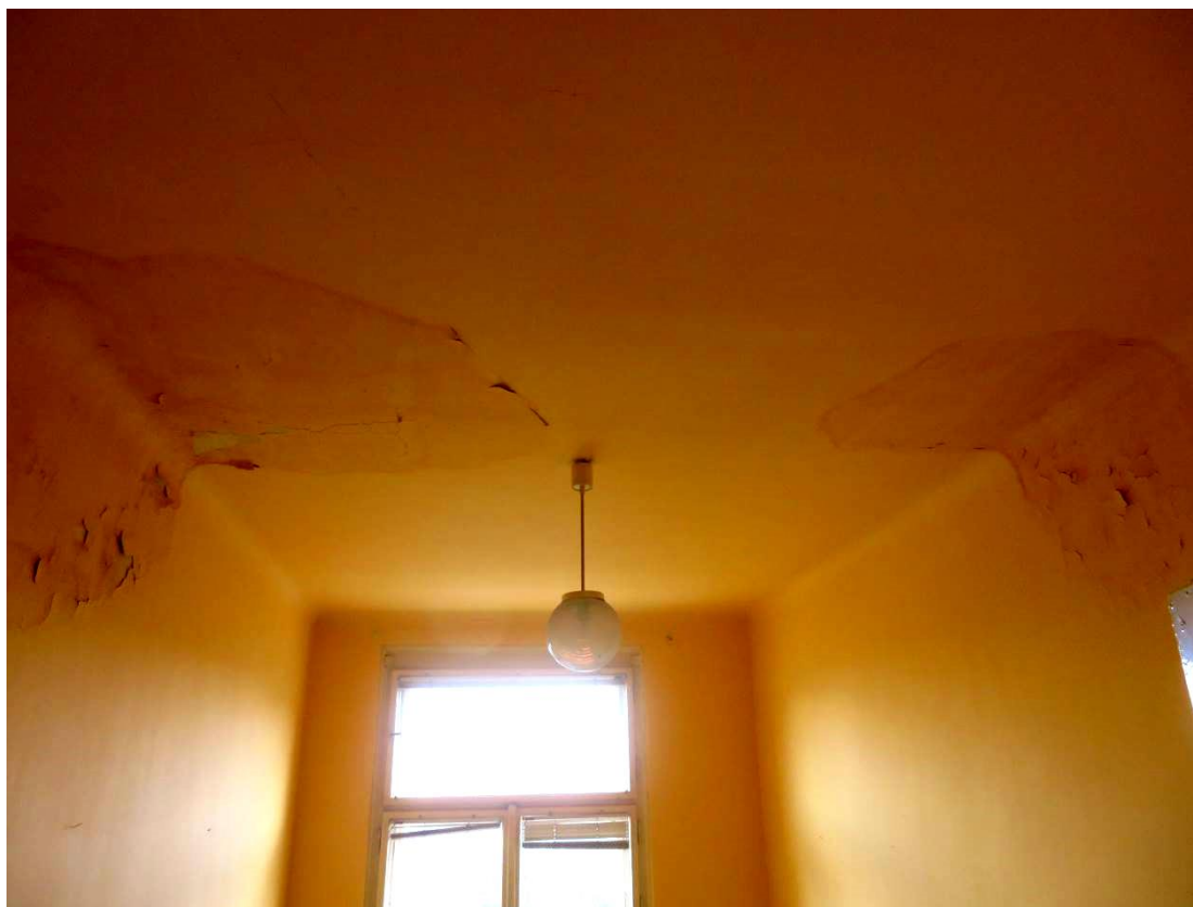
Foto 65 – Zikova 1 – 3.NP (lokalizace v Příloze 1) – viditelný průsak způsobený havárií vody nebo odpadů
