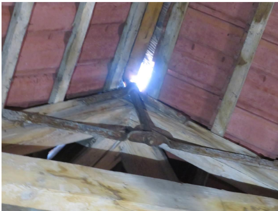
Foto 157 – Šolínova 1 – 6.NP (lokalizace v Příloze 1) – patrný charakter konstrukce krovu, nebyla zjištěna koroze dřeva ani jiné významné poruchy, lokální porucha v oblasti průchodu hromosvodu hřebenem viz Foto 3 – nedosedá oplechování detailu ! hrozí zatékání
