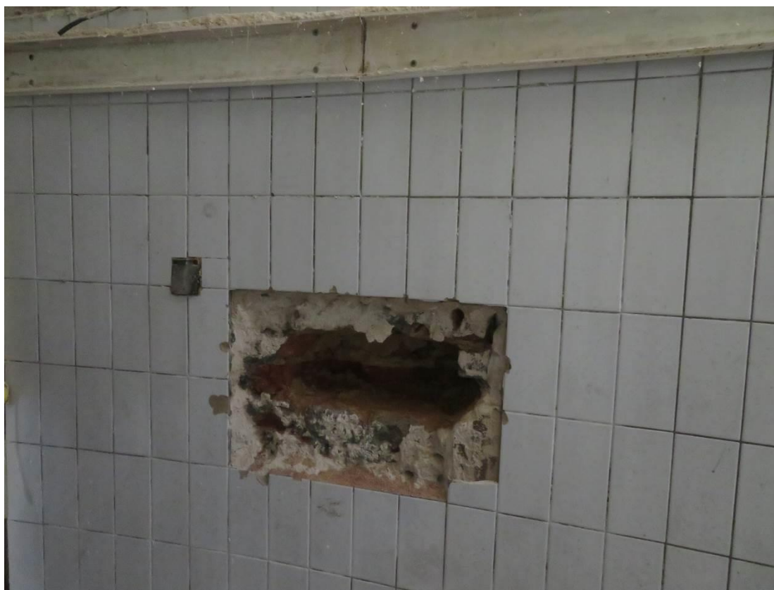
Foto 48 – Zikova 1 – 1.PP – sonda Z3 – viditelné cihly plné pálené a betonové, odběr vzorku cihly C3/2, v sondě patrná zvýšená vlhkost zdiva
