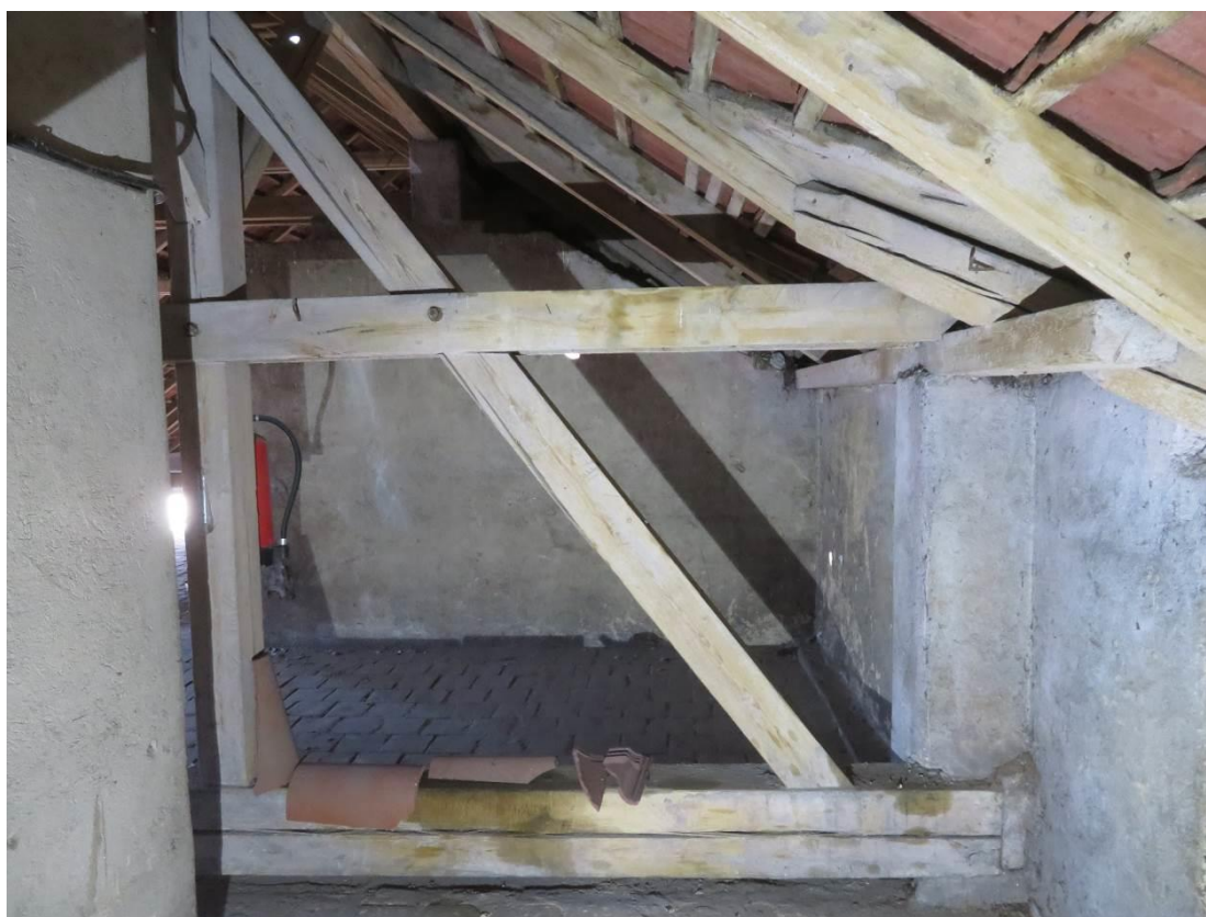
Foto 156 – Šolínova 1 – 6.NP (lokalizace v Příloze 1) – patrný charakter konstrukce krovu, nebyla zjištěna koroze dřeva ani jiné významné poruchy
