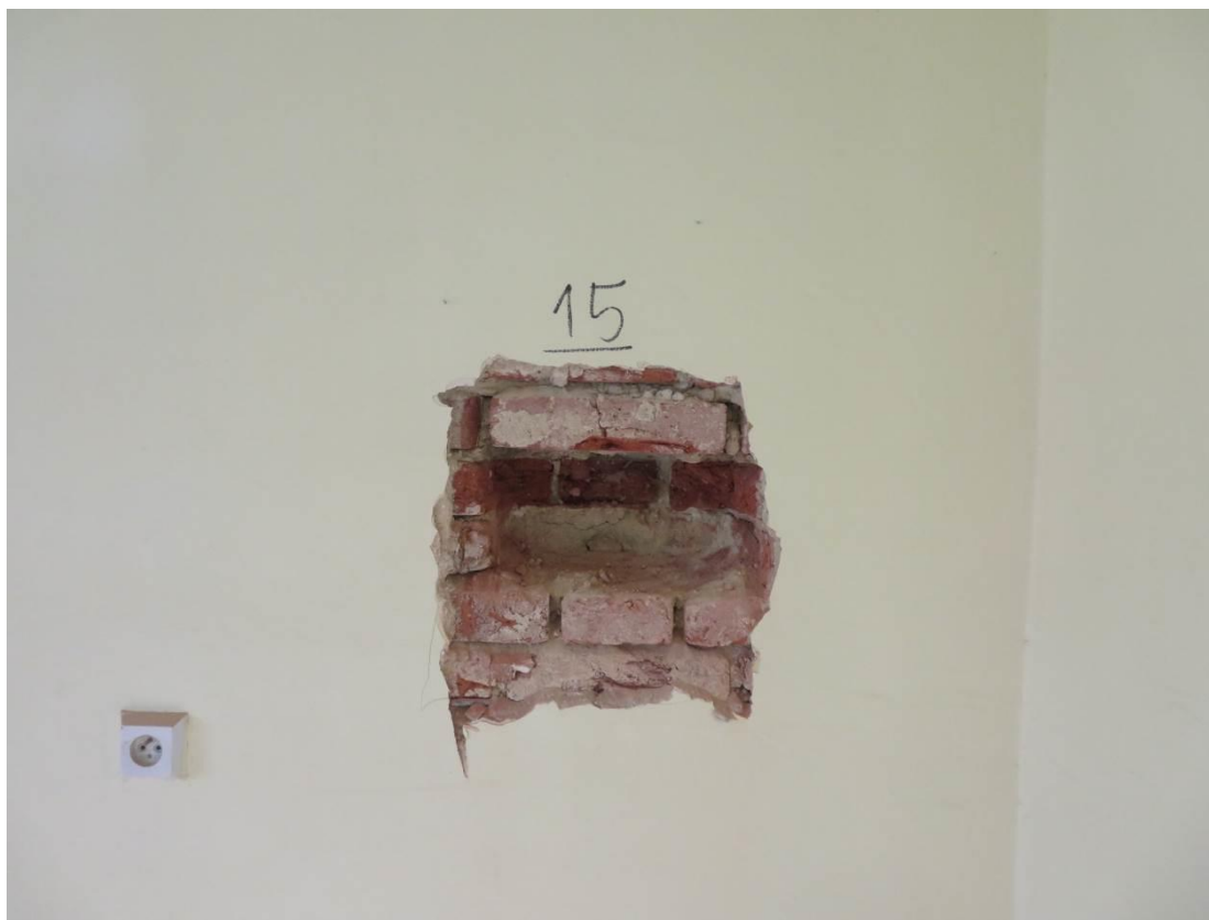
Foto 27 – Objekt Šolínova 1 – 5.NP – sonda Z15 – viditelné cihly plné pálené, odběr vzorku cihly C1/2
