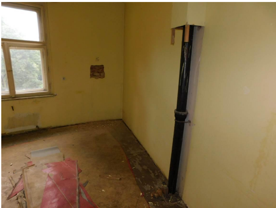
Foto 148 – Zikova 1 – 3.NP (lokalizace v Příloze 1) – zjištěn kanalizační svod v místnosti
