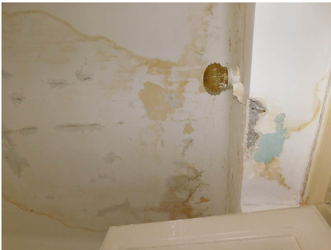
Foto 150 – Zikova 1 – 4.NP (lokalizace v Příloze 1) – zjištěny plošné průsaky způsobené havárií rozvodů vody či kanalizace
