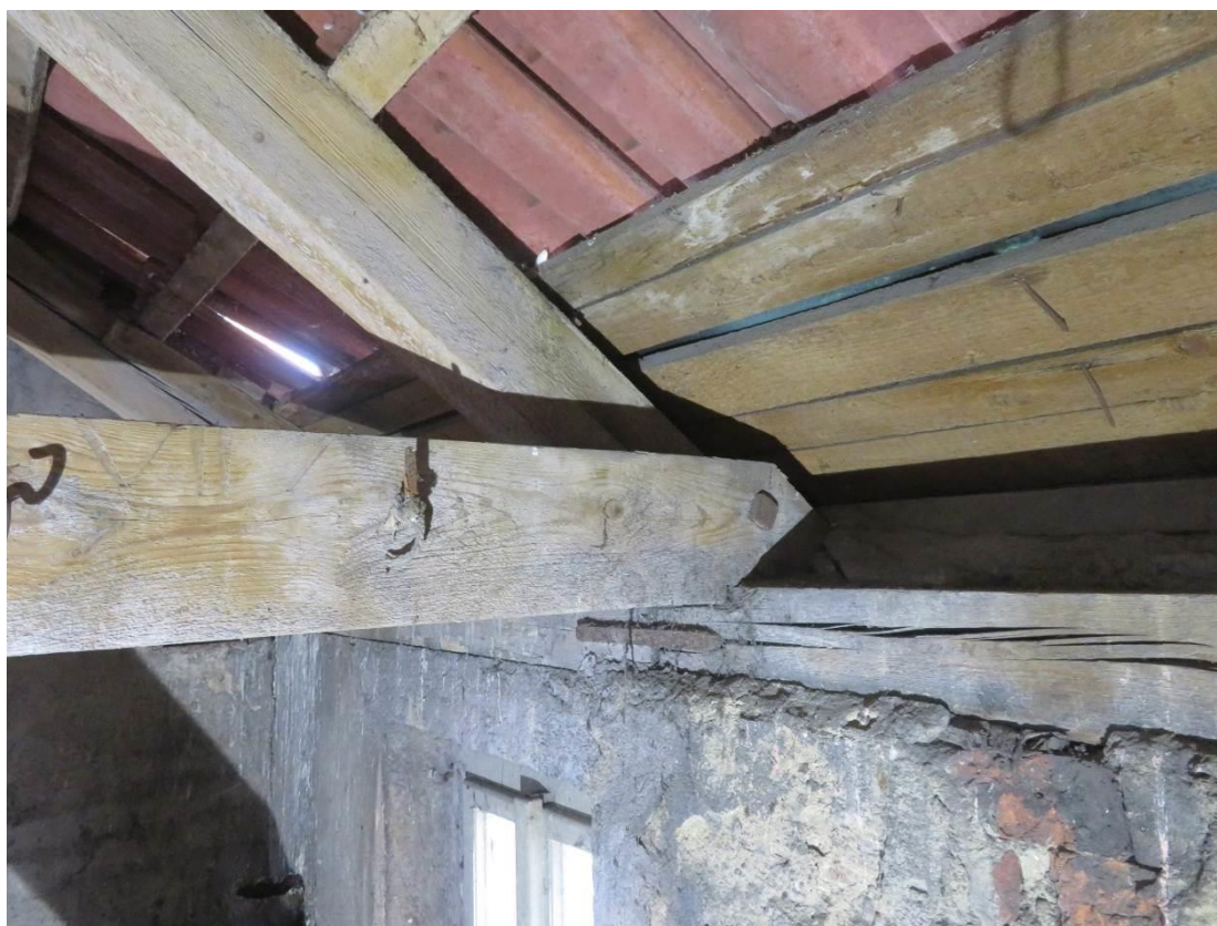
Foto 158 – Šolínova 1 – 6.NP (lokalizace v Příloze 1) – patrný charakter konstrukce krovu, nebyla zjištěna koroze dřeva ani jiné významné poruchy
