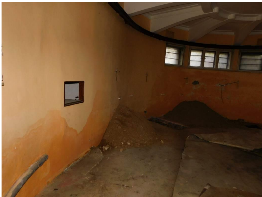
Foto 45 – Zikova 1 – 1.PP (lokalizace v Příloze 1) – viditelná zvýšená vlhkost zdiva
