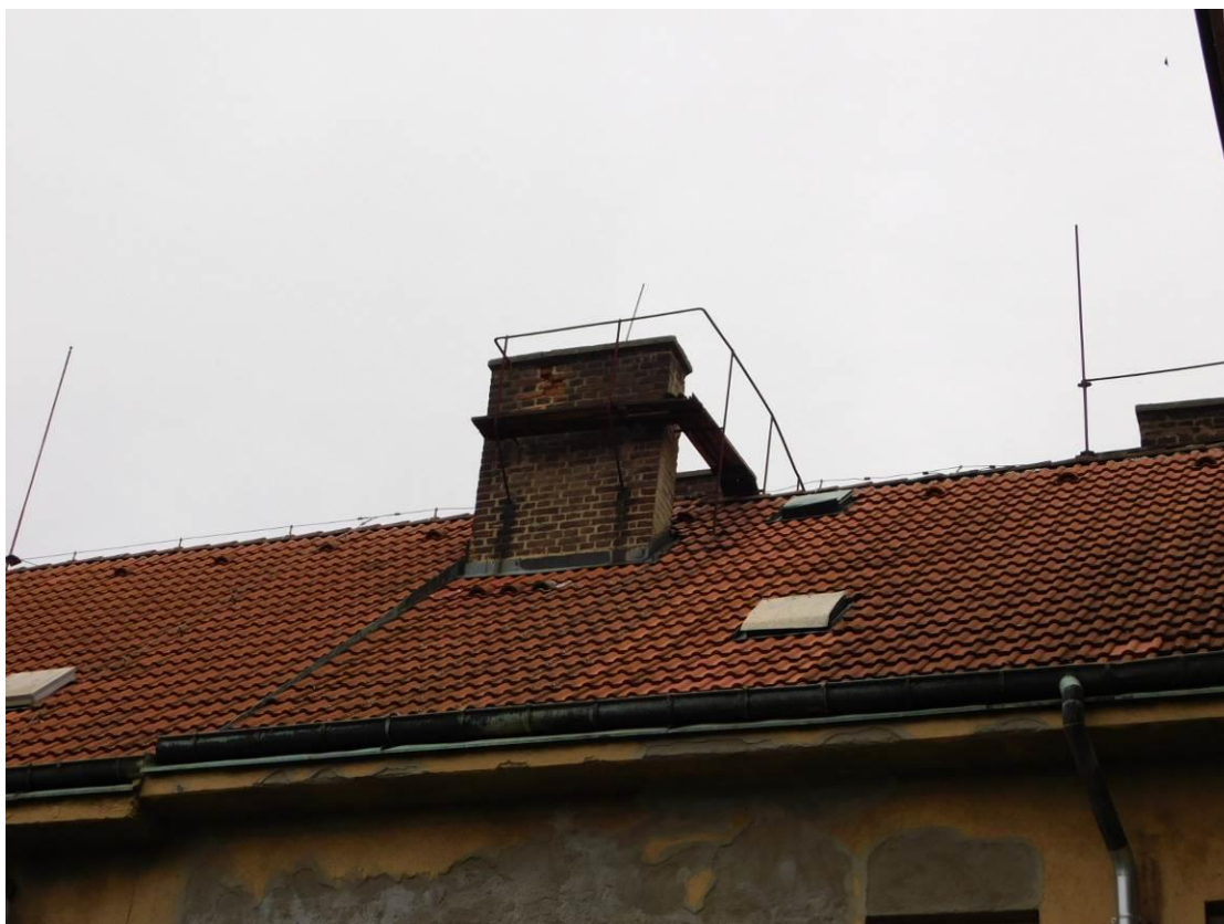
Foto 11 – Celkový pohled na střešní krytinu objektu Šolínova 3 – pohled dvorní – bez viditelných poruch
