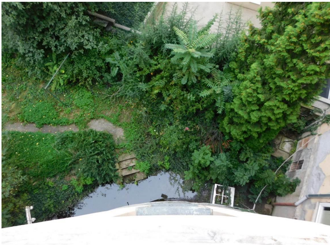
Foto 13 – Objekt Zikova 1 – dvůr – viditelné zadržení dešťové vody v oblasti soklu
