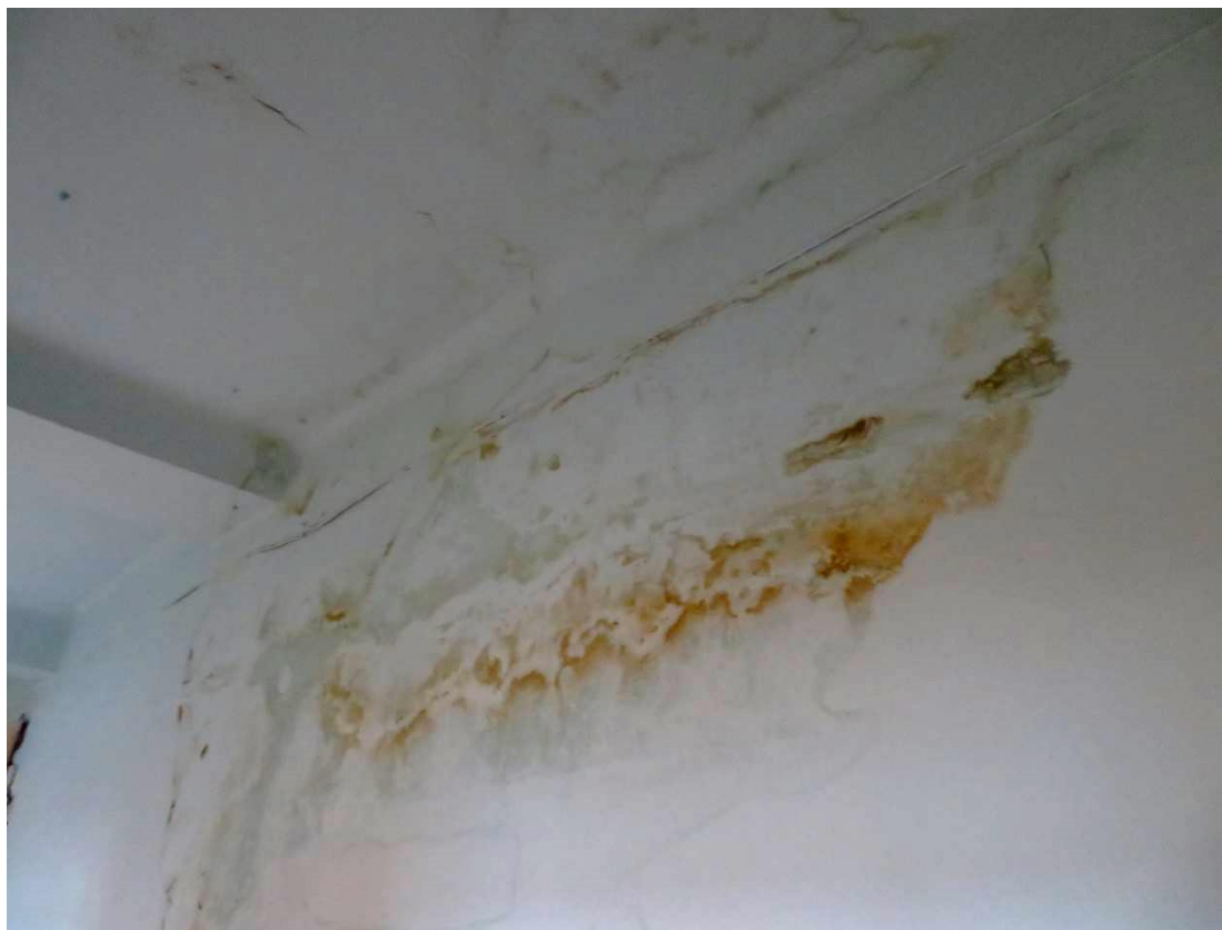
Foto 64 – Zikova 1 – 3.NP (lokalizace v Příloze 1) – viditelný průsak způsobený havárií vody nebo odpadů
