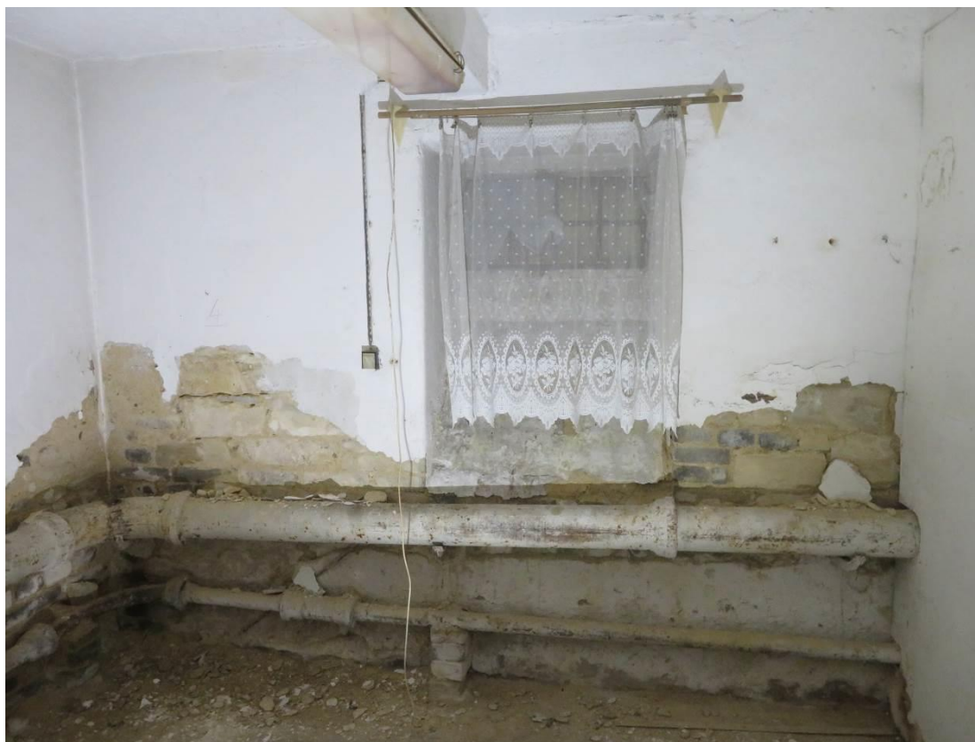
Foto 35 – Šolínova 3 – 1.PP – sonda Z4 – zdivo smíšené z opuky a betonových cihel, viditelná zvýšená vlhkost zdiva obvodové stěny
