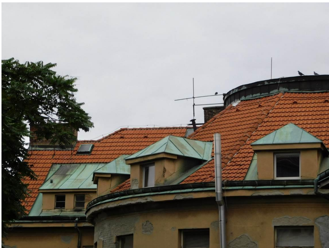
Foto 9 – Celkový pohled na střešní krytinu objektu Zikova 1 – pohled dvorní – bez viditelných poruch
