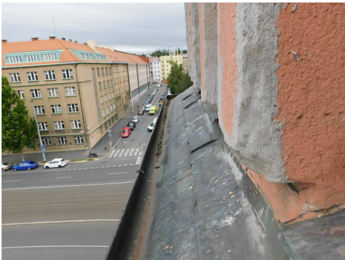
Foto 15 – Objekt Šolínova 1 – pohled na charakter provedení oplechování římsy a vodorovného dešťového svodu – bez viditelných poruch
