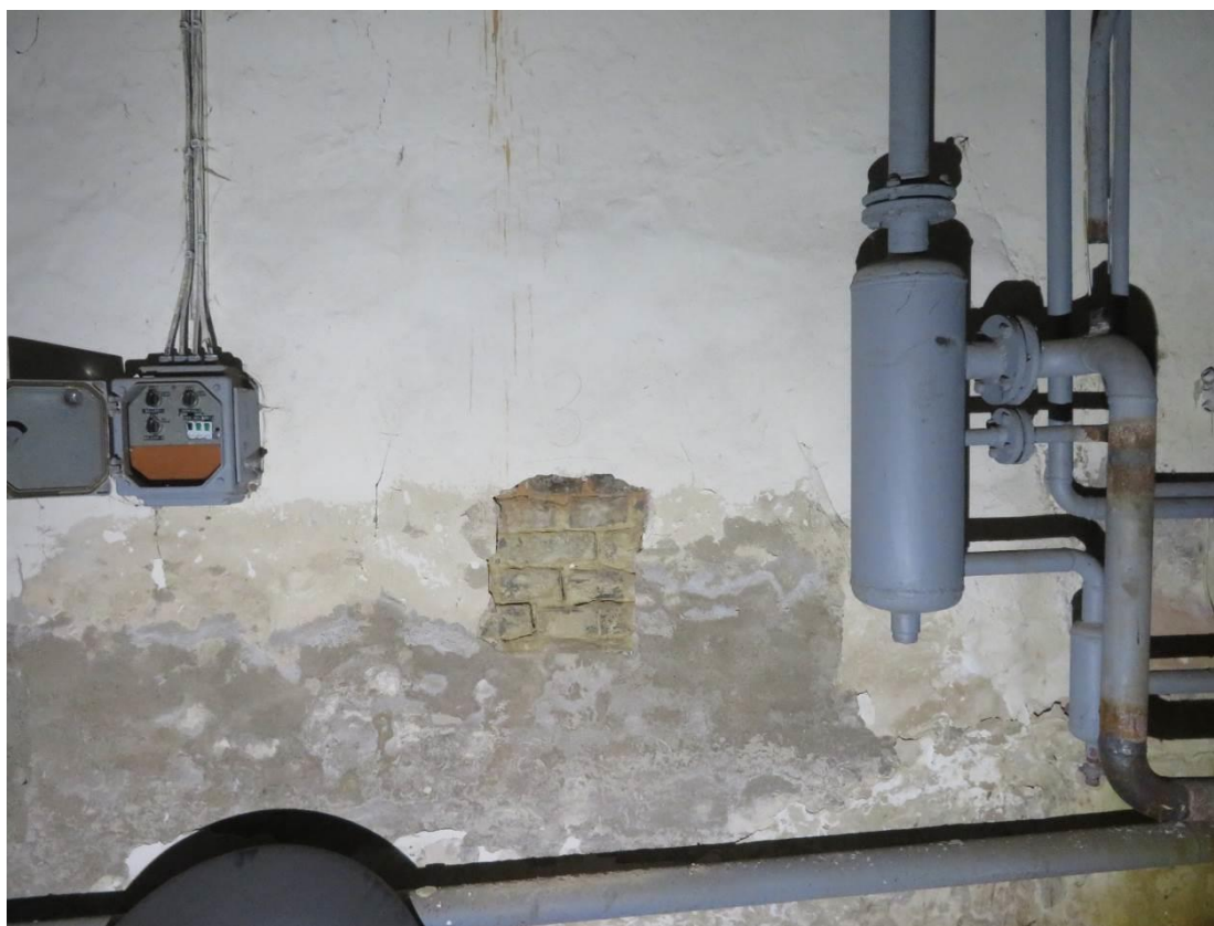
Foto 34 – Šolínova 3 – 1.PP – sonda Z3 – zdivo z betonových cihel, viditelná zvýšená vlhkost zdiva středové stěny
