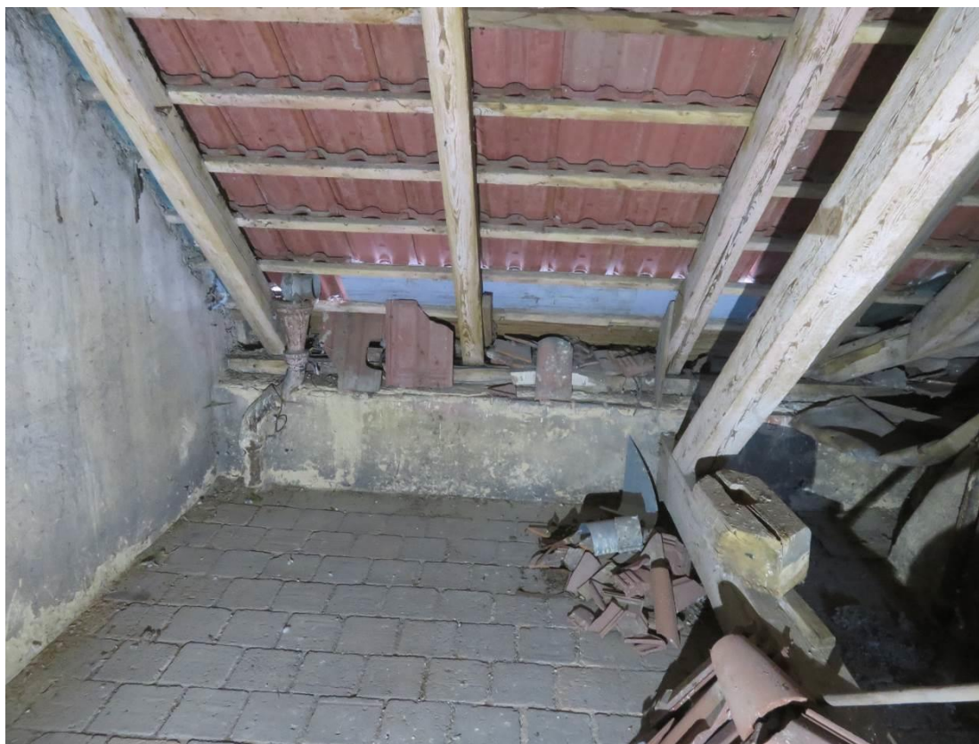
Foto 167 – Zikova 1 – 5.NP (lokalizace v Příloze 1) – patrný charakter konstrukce krovu, nebyla zjištěna korozí dřeva ani jiné významné poruchy
