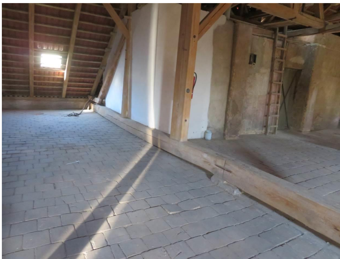
Foto 162 – Šolínova 3 – 5.NP (lokalizace v Příloze 1) – patrný charakter konstrukce krovu, nebyla zjištěna koroze dřeva ani jiné významné poruchy
