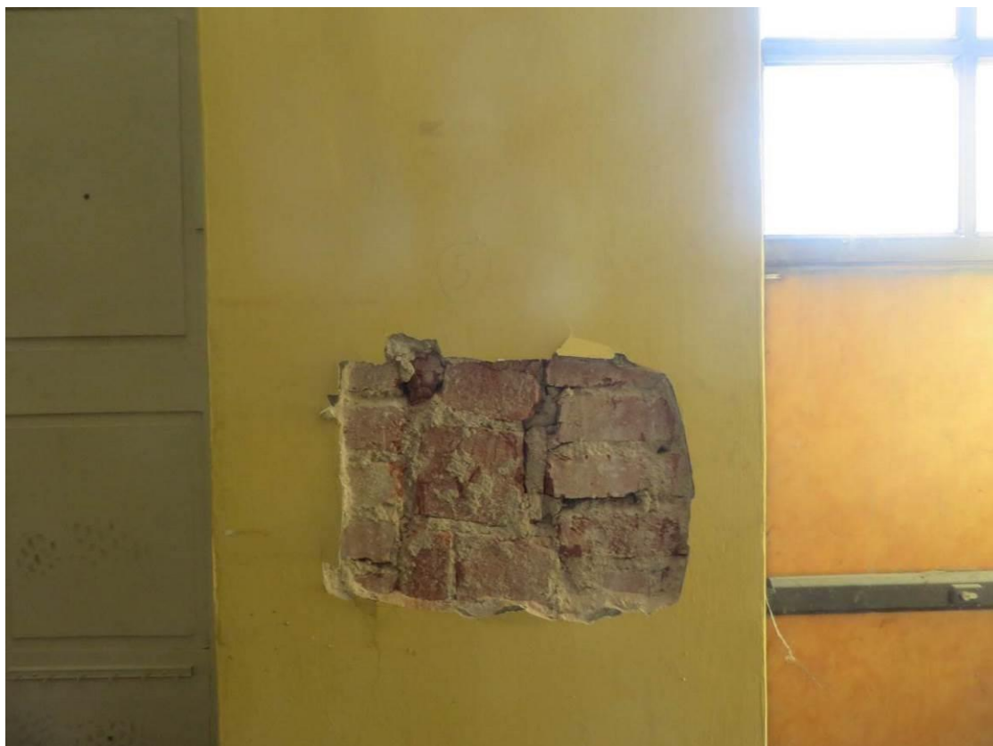
Foto 21 – Objekt Šolínova 1 – 1.NP – sonda Z5 – viditelné cihly plně pálené, v pilíři je schovaná stoupačka
