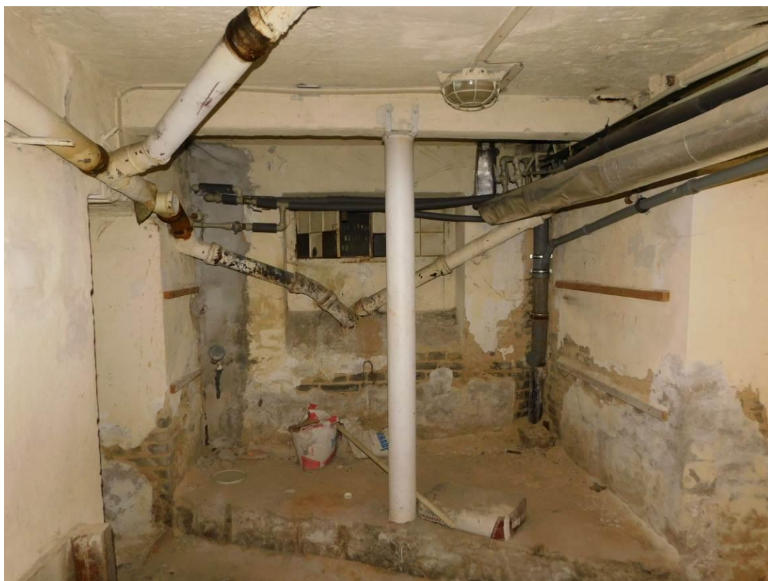
Foto 20 – Objekt Šolínova 1 – 1.PP (lokalizace v Příloze 1) – viditelná zvýšená vlhkost obvodové dvorní stěny, viditelné podepření stropu ocelovým sloupem
