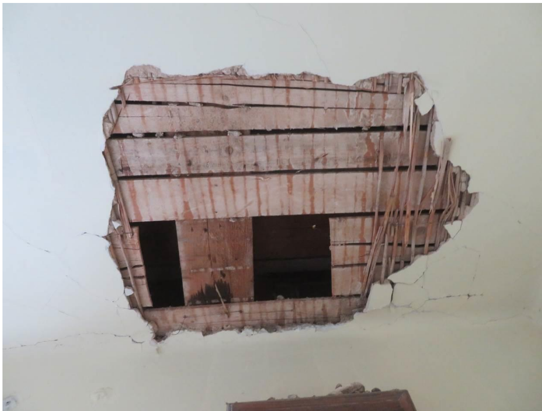
Foto 105 – Šolínova 3 – 2.NP – sonda SS16 – dřevěný trémový strop
