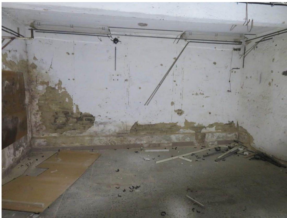
Foto 31 – Objekt Šolínova 3 – 1.PP – sonda Z1 – smíšené zdivo z opuky a betonových cihel, viditelná zvýšená vlhkost zdiva středové stěny
