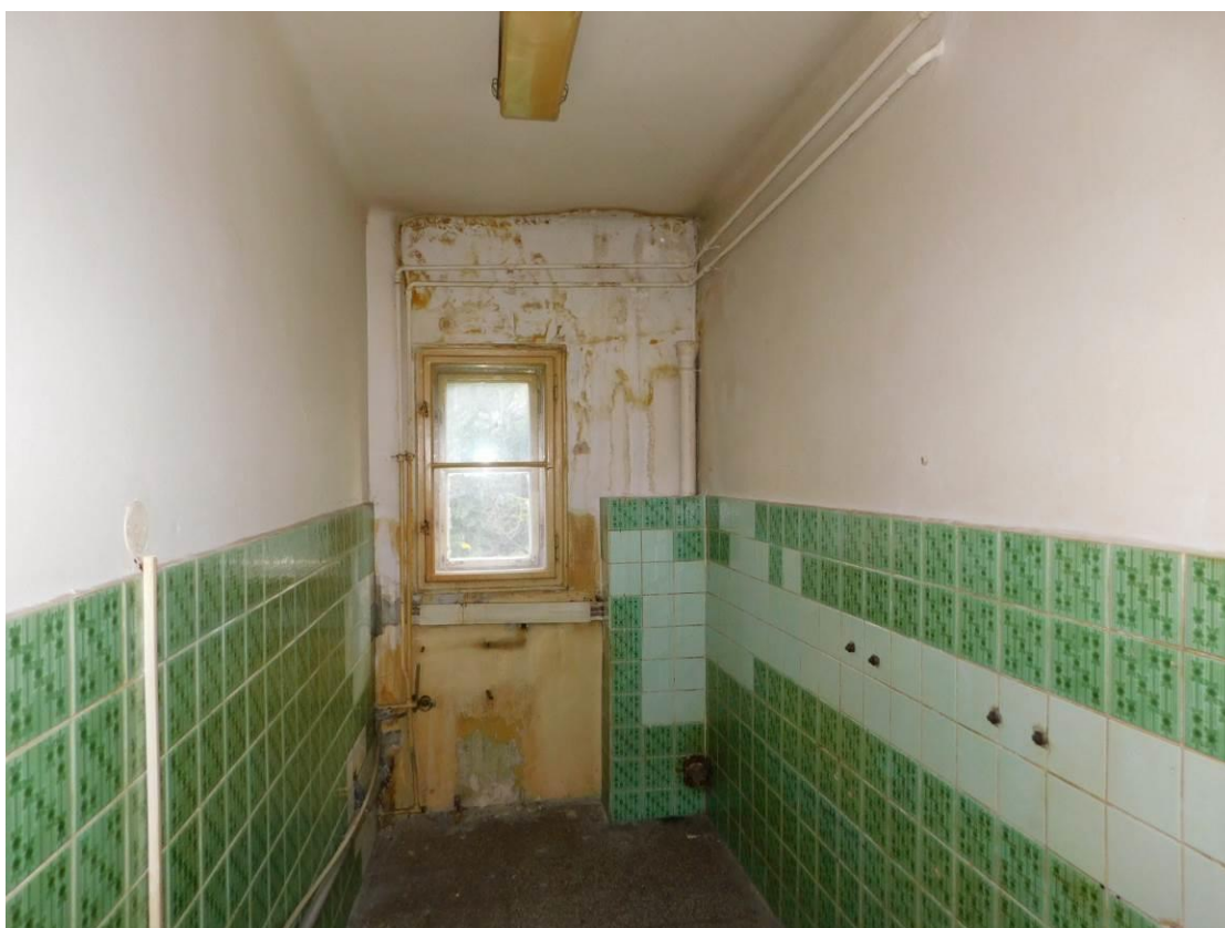
Foto 151 – Šolínova 3 – 4.NP (lokalizace v Příloze 1) – lokální průsak pravděpodobně z dešťového svodu
