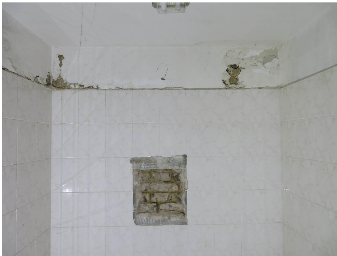
Foto 49 – Zikova 1 – 1.PP – sonda Z2 – viditelné betonové cihly, viditelné vztlínání vlhkosti nad úrovní obkladu
