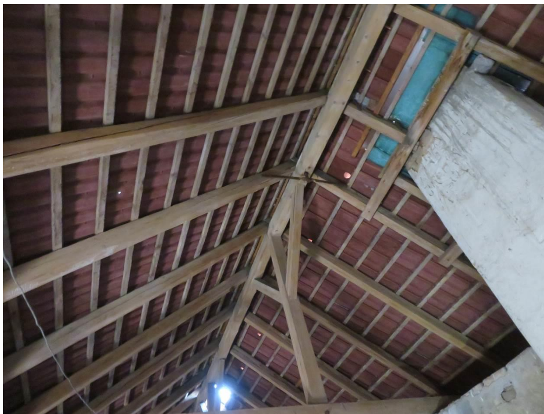
Foto 165 – Šolínova 3 – 5.NP (lokalizace v Příloze 1) – patrný charakter konstrukce krovu, nebyla zjištěna koroze dřeva ani jiné významné poruchy
