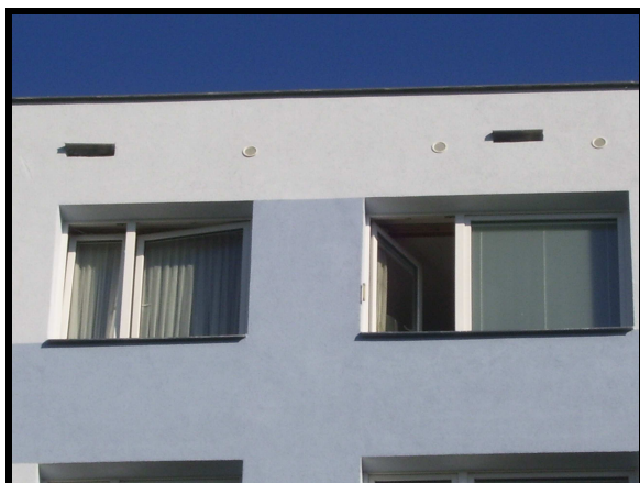
Možný kompromis – ponechání části VP volných, osazených stříškou proti zatékání (Kupeckého 761-763)
