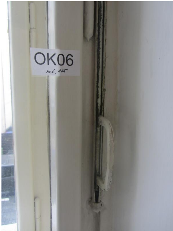
Táhlo před opravou
