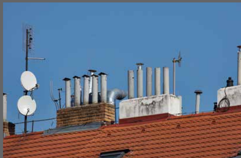
Potrubí vzduchotechniky a satelitní antény nad hřebenem střechy
