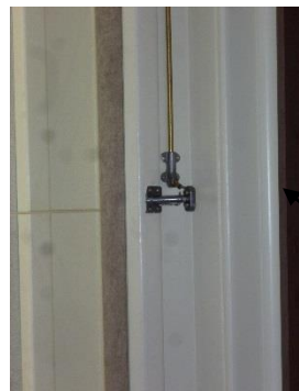
detail zrepasovaného táhla u okna
