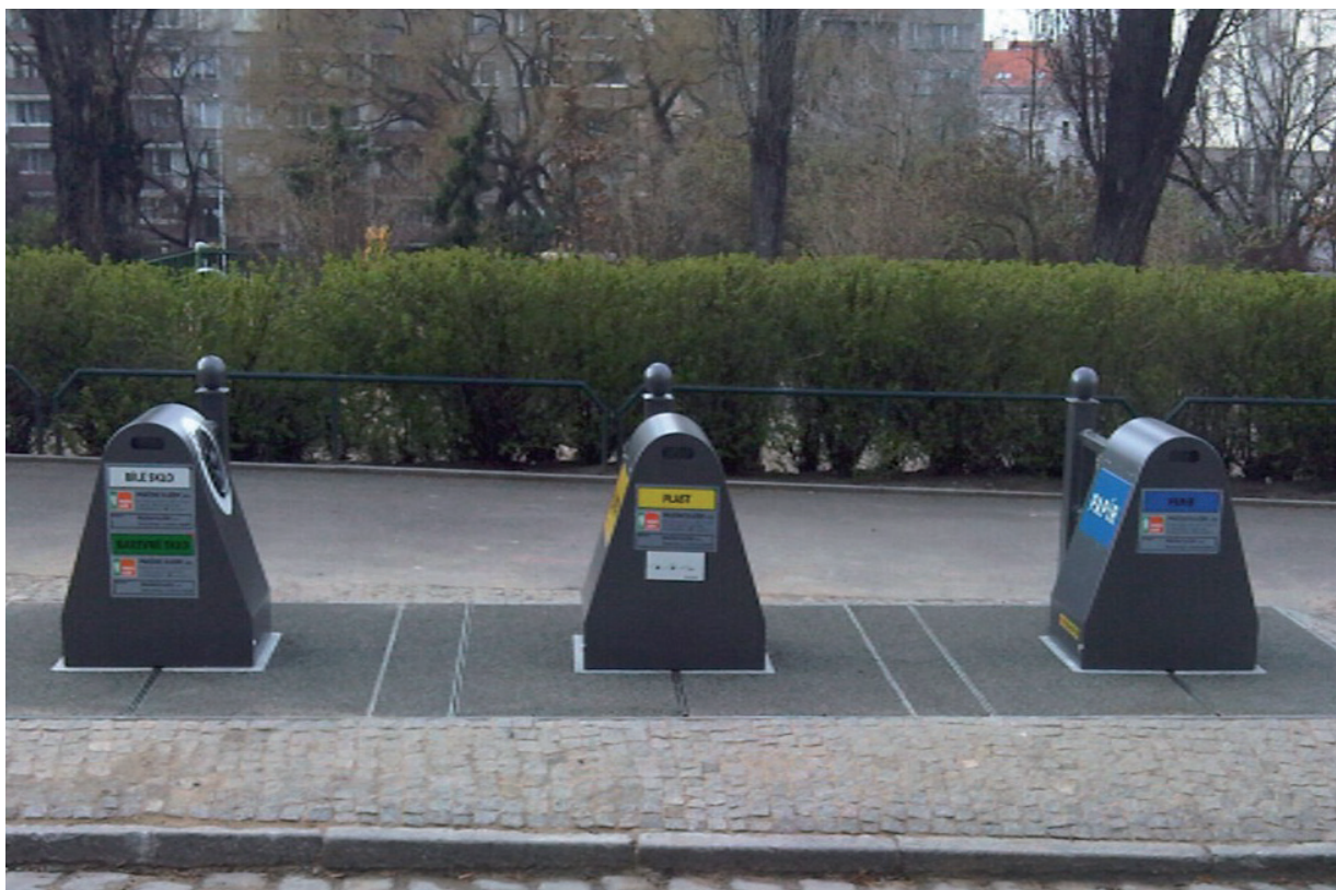
Obr. B4.2.3: Podzemní kontejnery na separovaný odpad instalované v roce 2010 v Praze 3 (Žižkovo nám.)
